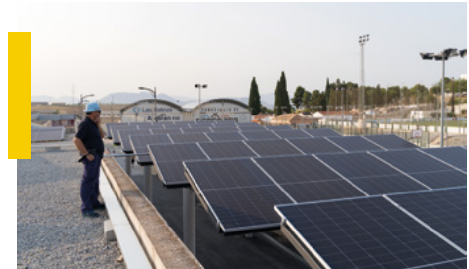
↗ Nuevas placas fotovoltaicas en la piscina cubierta de Las Gabias
